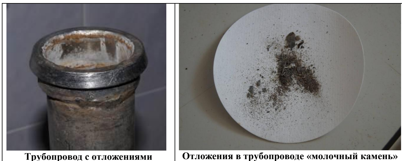
Рисунок 1 – Трубопровод и отложения «молочного камня».
